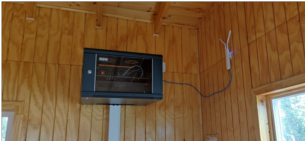
Figura 28: Rack instalado en Oficina de Administración, Río Clarillo
