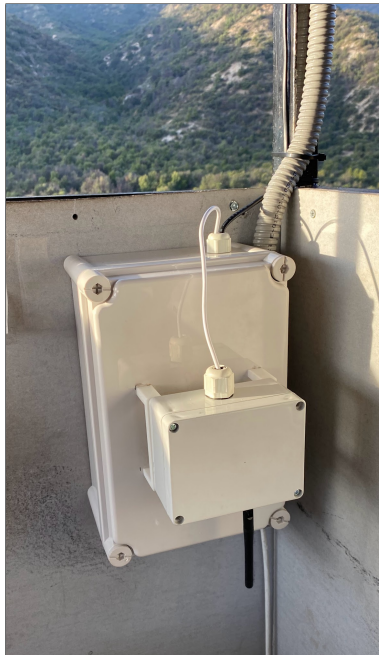
(a) Módulo solar
