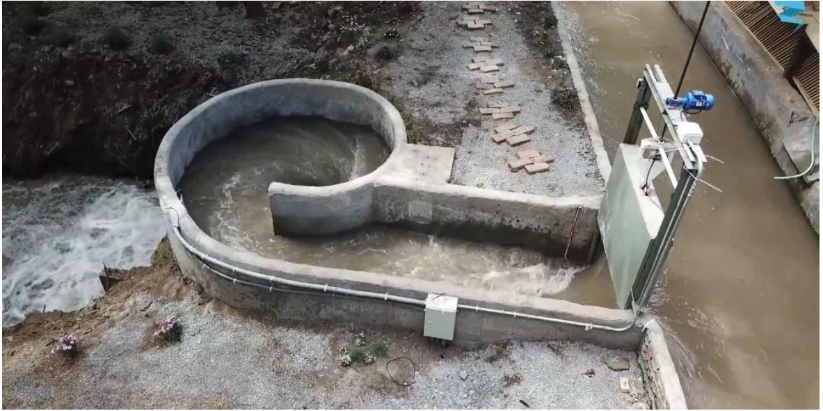
Figura 17 Turbina de Vórtice Gravitacional, micro hidroeléctrica potencia de 15kW, Doñihue Chile Fuente: AGRYD (2018)
