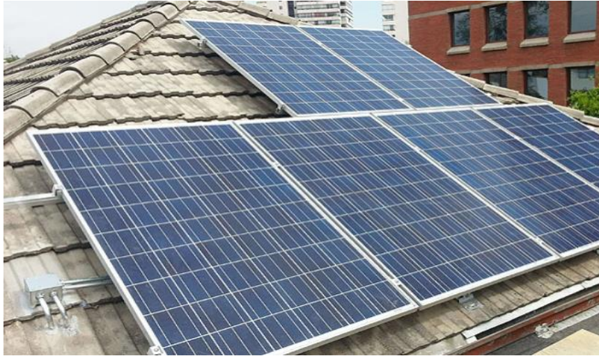
Figura 2.6: Paneles implementados en vivienda
